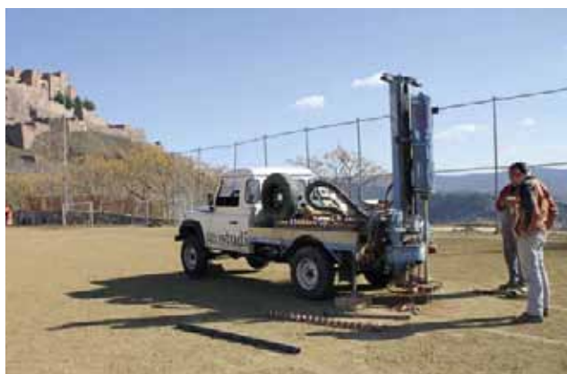
Els tècnics fent les comprovacions i prenen les mesures necessàries per a l'estudi geotècnic
